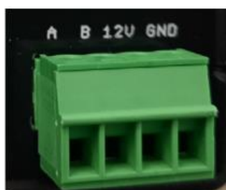
Svorkovnice vyhodnocovací jednotky v rozvaděči
